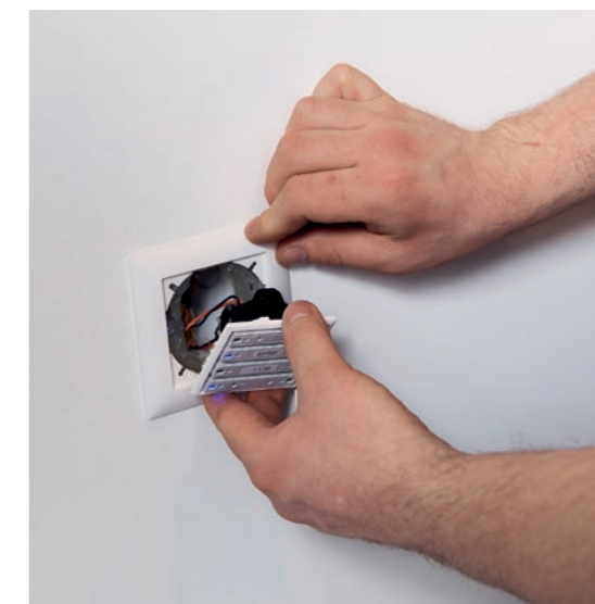
10 | Servicegeschäft Smart Building Mehr Servicearbeiten dank Smart Building
