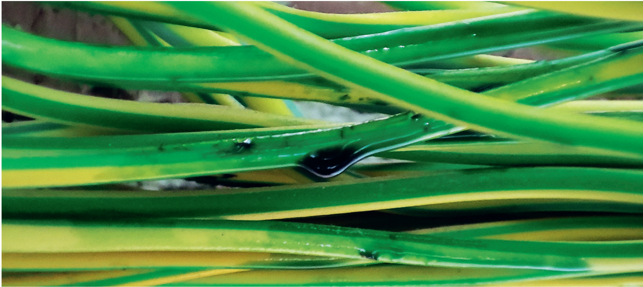
Masse verte s'échappant des fils de protection à la borne collectrice de protection dans une distribution électrique de 1975 (Kaspar Belser Elektroplanung)
