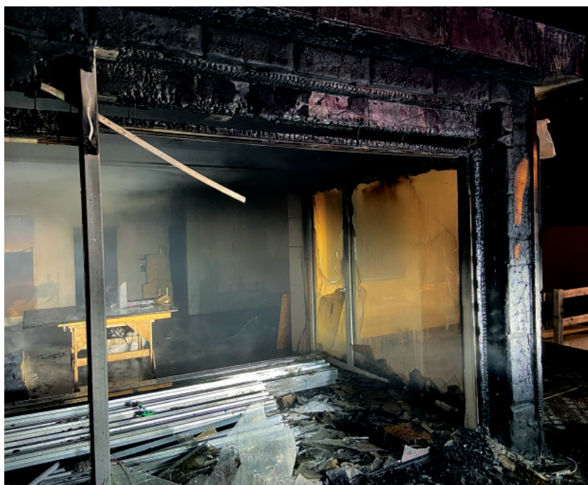
Un incendie sur un chantier entraîne de gros dégâts. La négligence en est souvent la cause.
